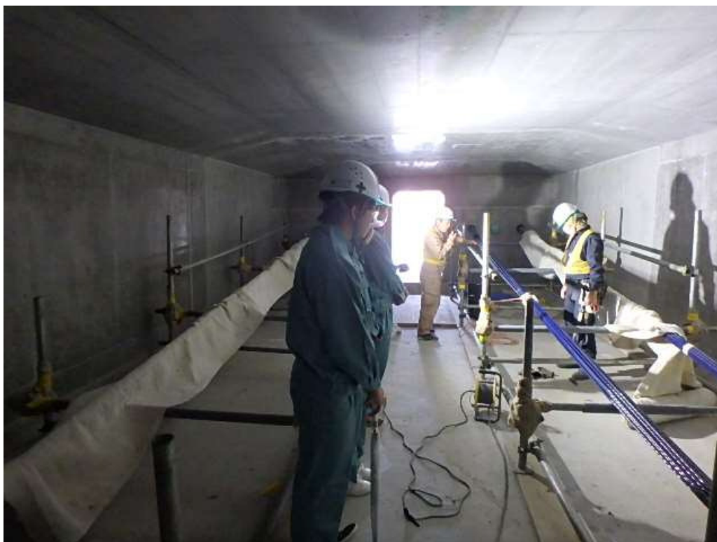
妙高市渋江川橋 ワーゲン施工の中央接合後、緊張用 PC 鋼材挿入を見学
